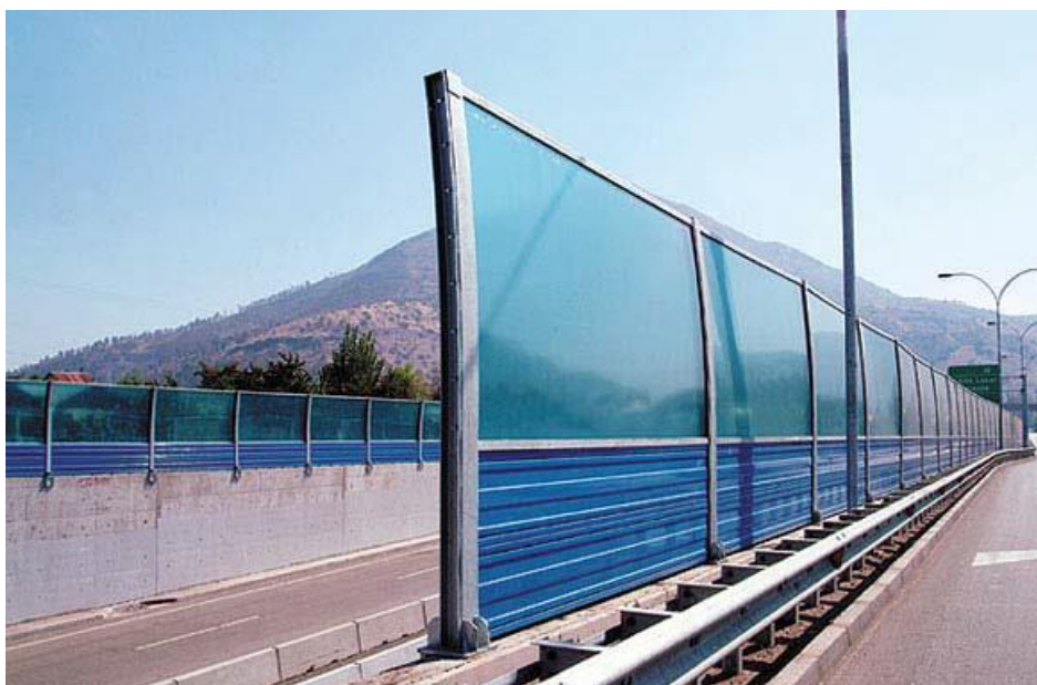
Barreira Acústica de Acrílico- Linha Vermelha, RJ
